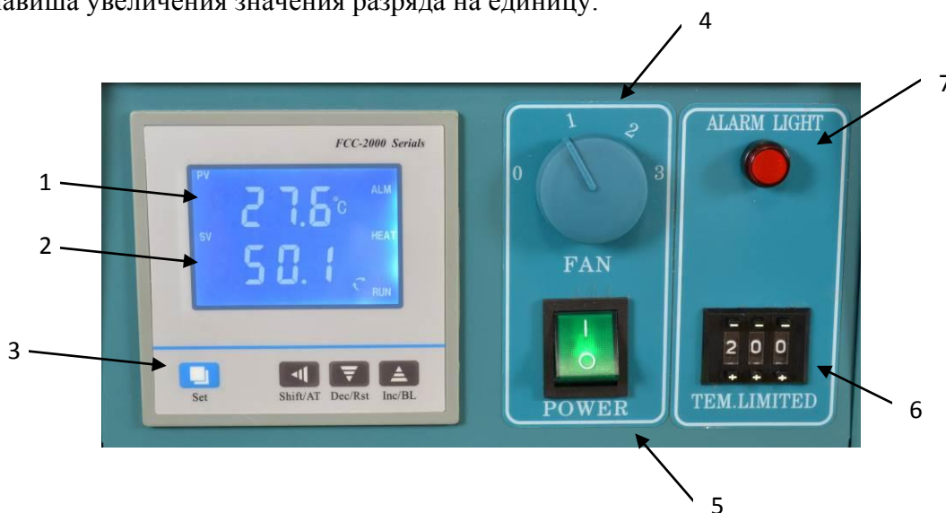
Рис. 5. Панель управл. шкафам.
